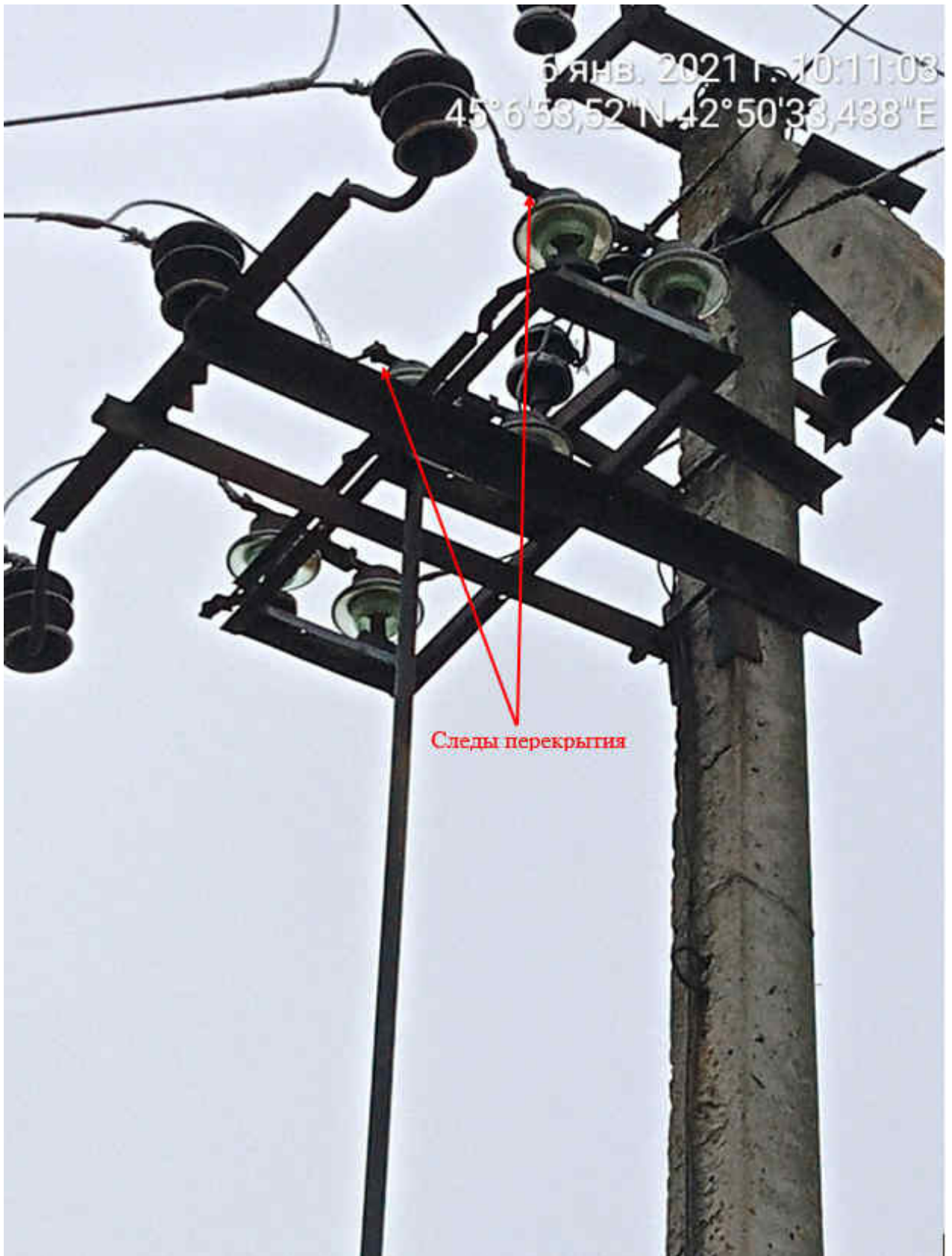
Места перекрытия на разъединителе Р-14-
