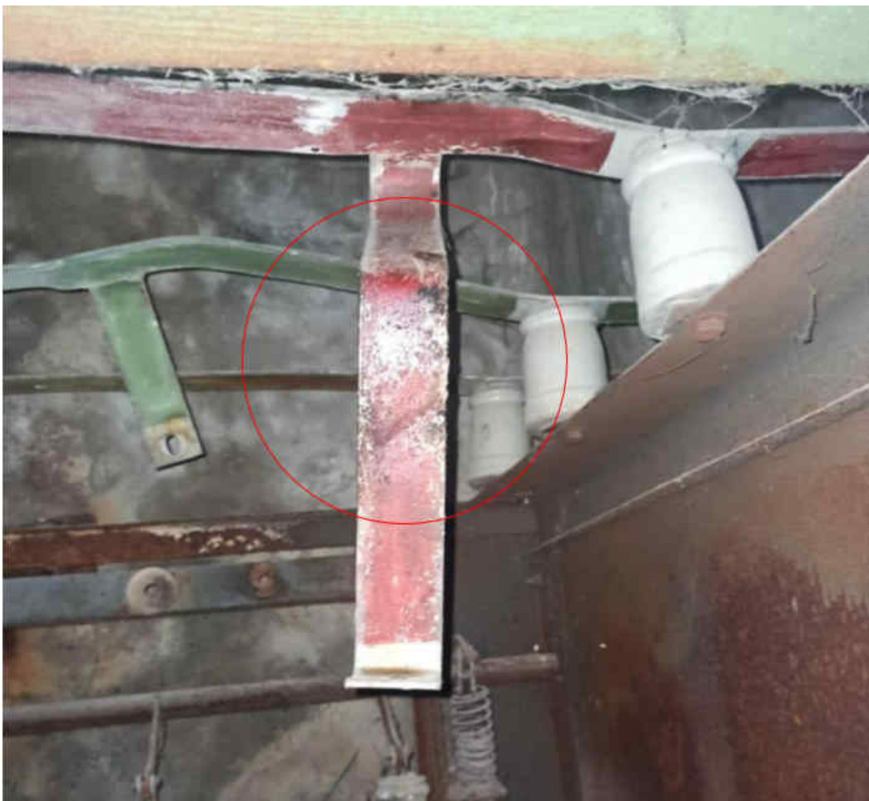
Шина фазы «С» 2 СШ 10 кВ со следами дугового перекрытия.
