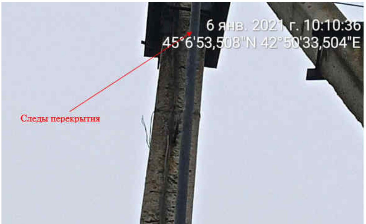
Место перекрытия на приводе разъединителя Р-14-1
