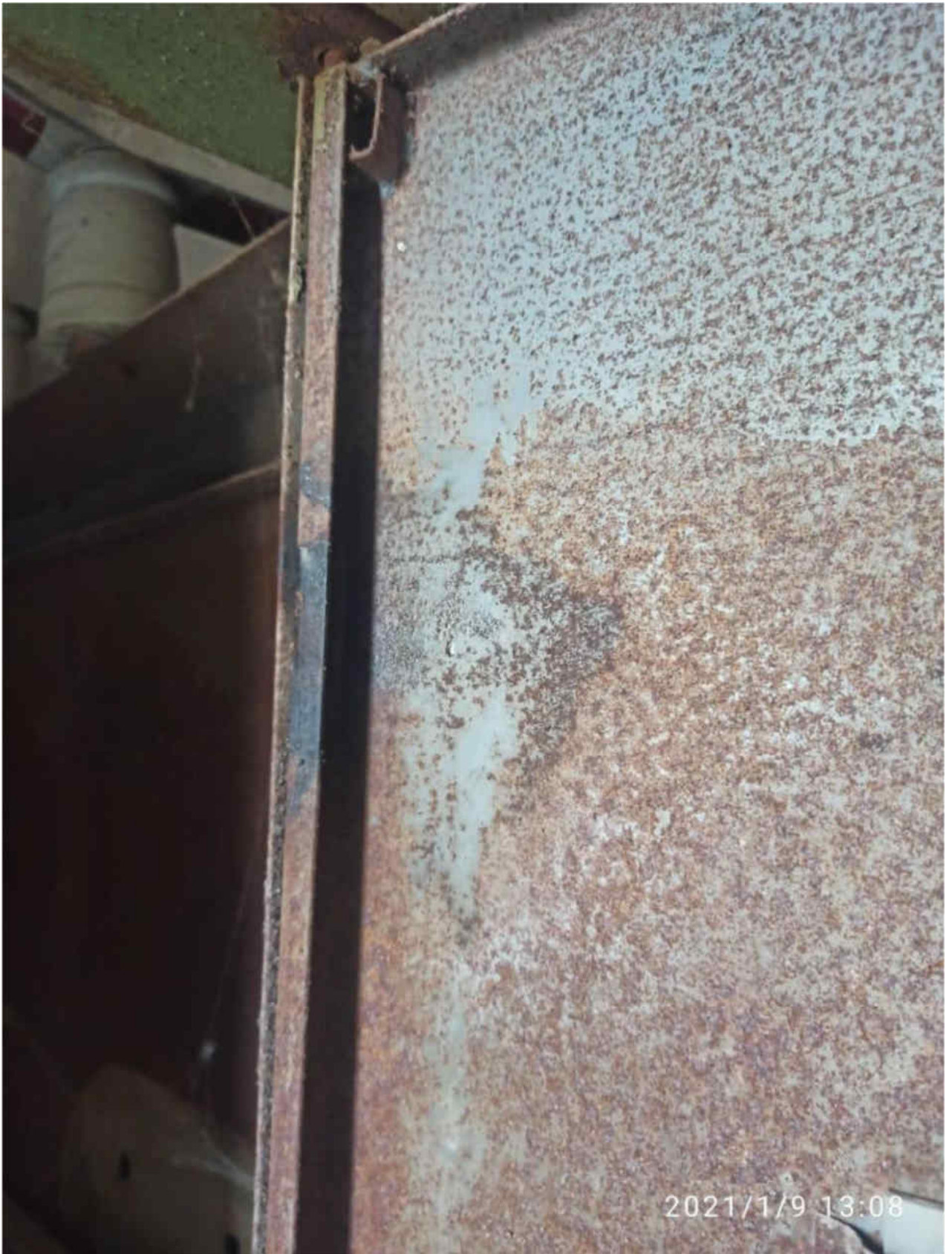
Дверь в камеру ВН Т-2 со следами электродугового перекрытия
