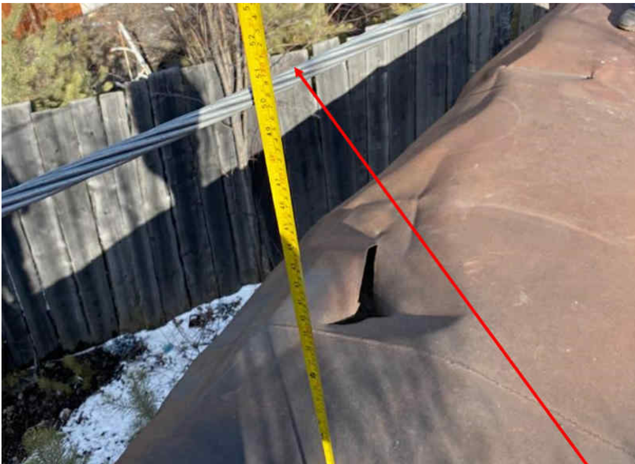
Место несчастного случая пролет опор № 7/5-7/6 ВЛ-10 кВ ф. 5810 (расстояние 1,3 м)
