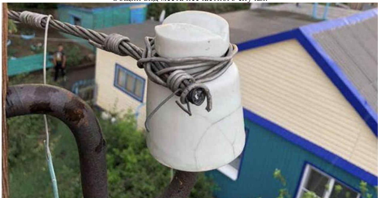
Общий вид изолятора, на котором произошел излом фазного магистрального провода
