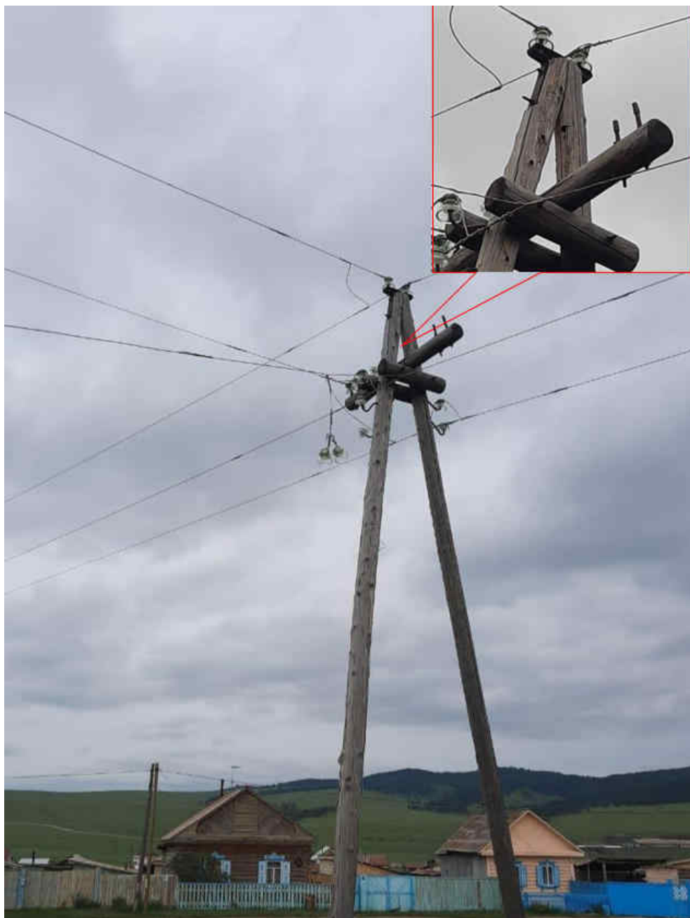
Состояние анкерной опоры №75 ЛЭП, срыв изоляторов со штырей.
