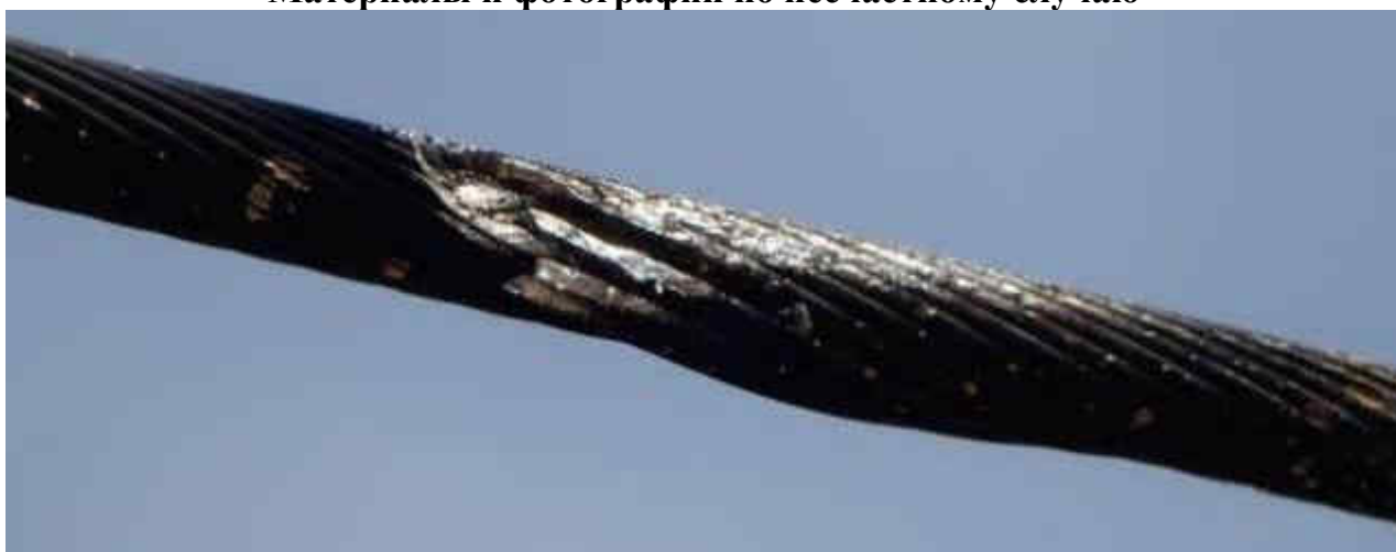
Повреждение нижнего провода ЛЭП
