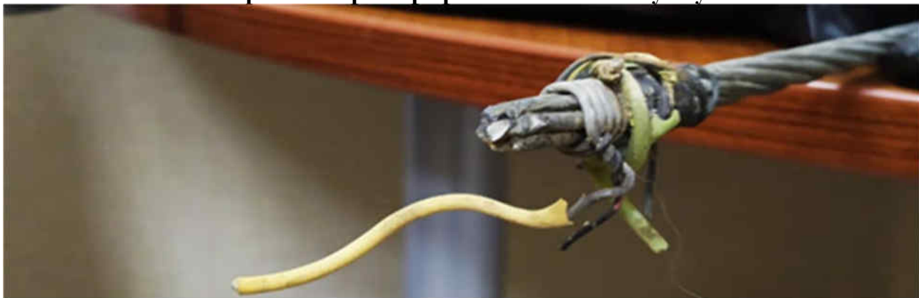
Фрагмент провода в месте излома
