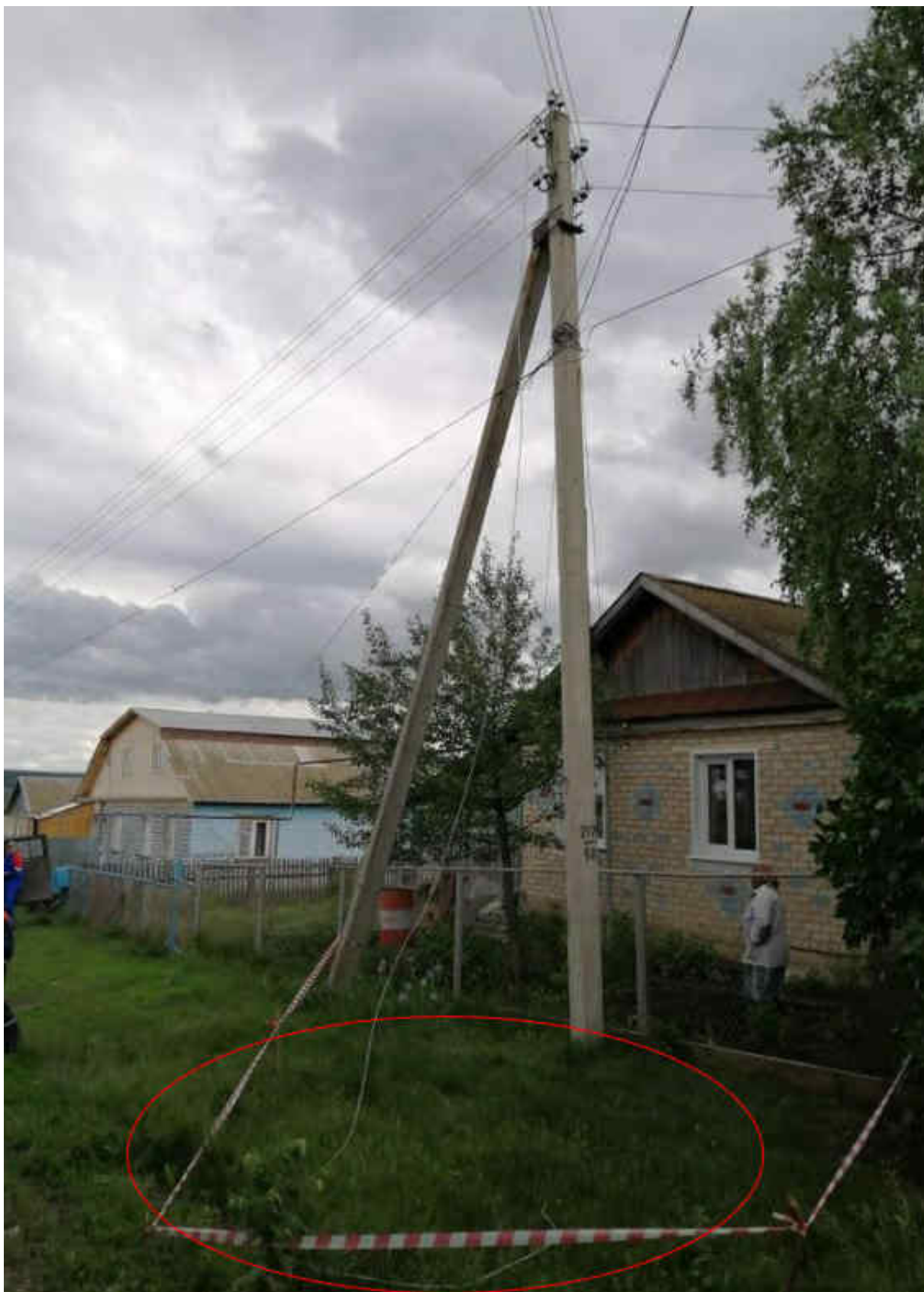
Обрыв провода в пролете № 217-218 ЛЭП
