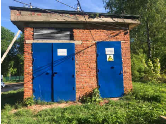
Входные двери ЗТП-380
