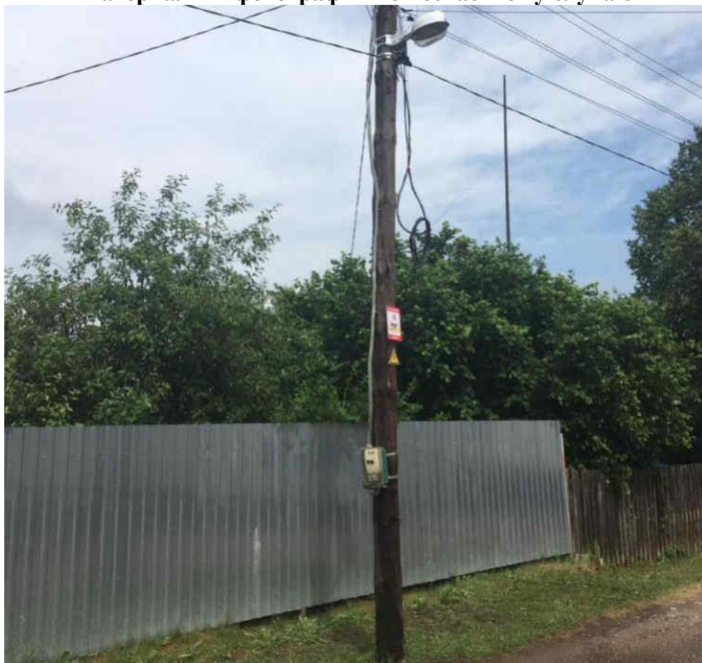
Место несчастного случая, опора ЛЭП №10
