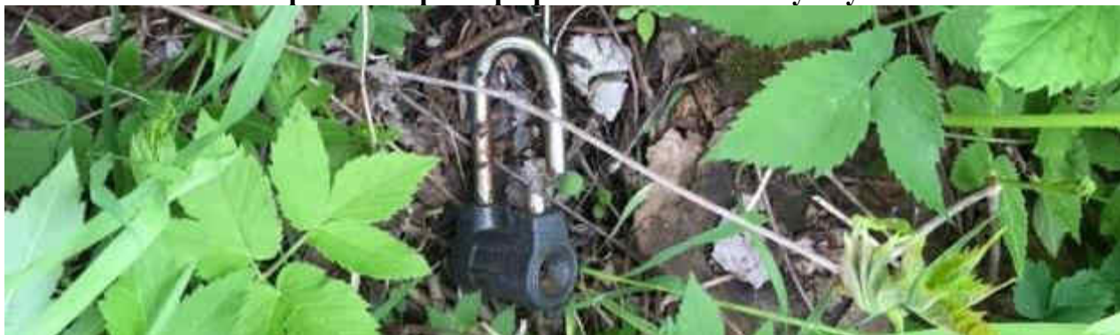
Поврежденный замок от дверей РУ 10 кВ ЗТП-380 Кондрово-Педучилище.
