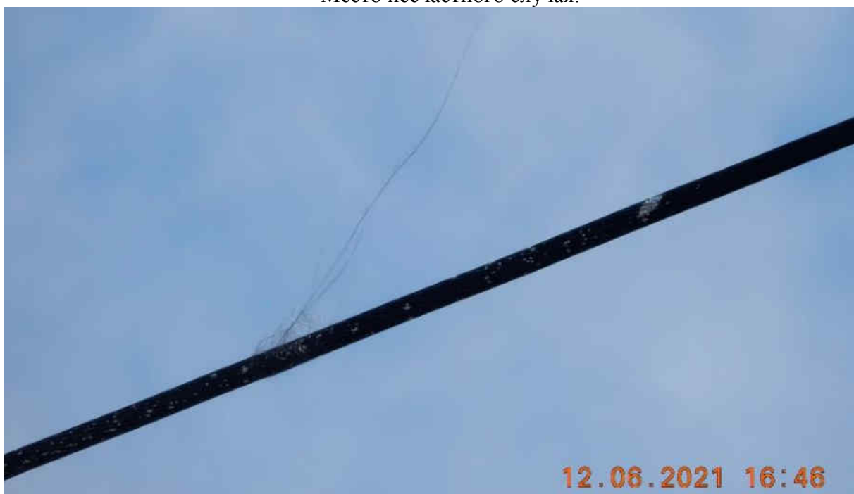
Метки и остатки лески на нижнем проводе отпайки ЛЭП.
